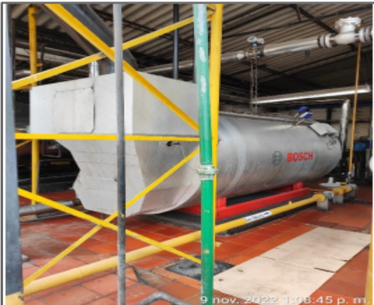
Fotografía 3. Caldera Bosch de 200 BHP
