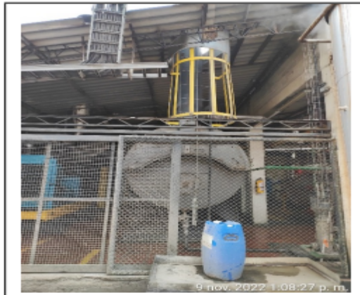
Fotografía 4. Caldera Metalcolmesa de 150 BHP
