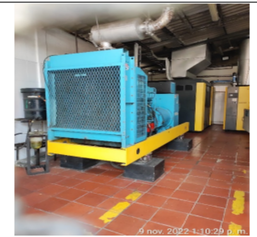
Fotografía 6. Planta eléctrica de 300 kW
