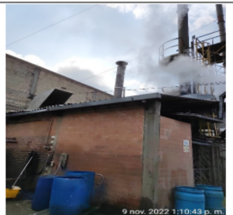
Fotografía 7. Ducto de la planta eléctrica
