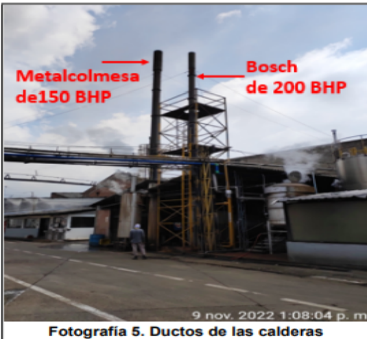
Fotografía 5. Ductos de las calderas
